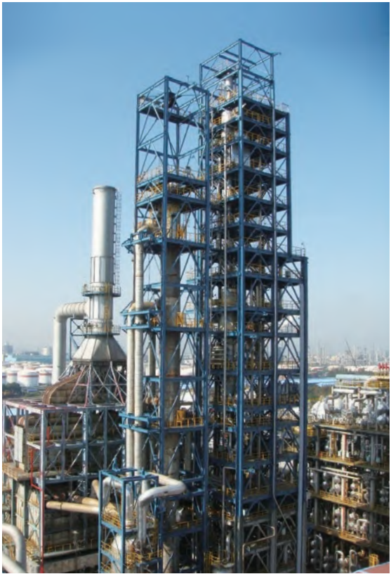
3# 加氢裂化装置投产后，将转化芳烃潜力较高的重质石脑油全部进重整装置处理，提高芳烃装置能源利用效率
